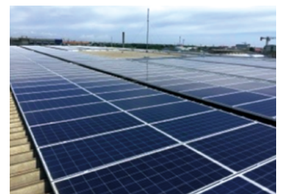
屋上に設置されたソーラーパネル
