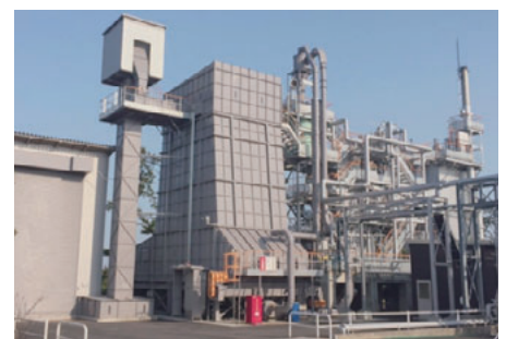
北陸工場 バイオマスボイラ
