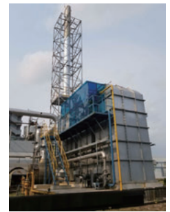
蓄熱燃焼装置(RTO)
