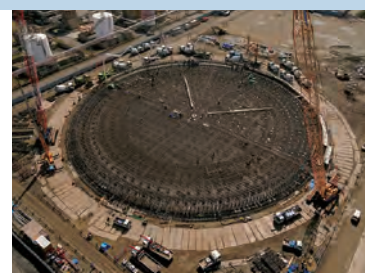
新居浜LNG基地
