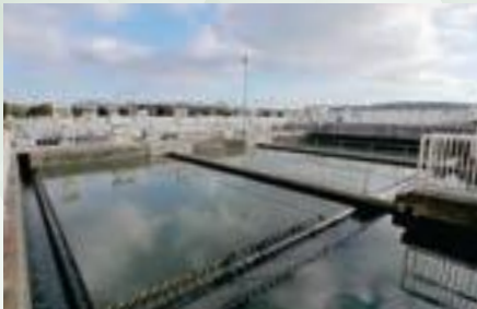
西部浄化センター
