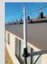
事務所棟に設置されたWi-Fi HaLow™対応アクセスポイント
