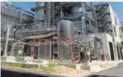
廃熱発電装置（ORC方式）
