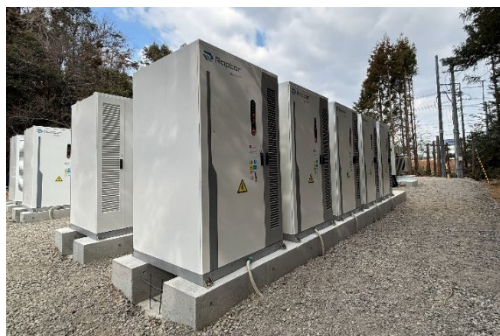
▲「ADW 三重松阪市蓄電所」
