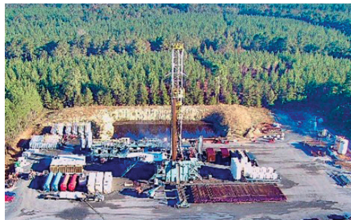
South Mansfield Shale Gas 開発・生産事業
