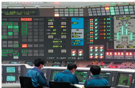
柏崎刈羽原子力発電所6号機中央制御室
