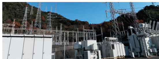
中国電力ネットワーク株式会社 玉野変電所
