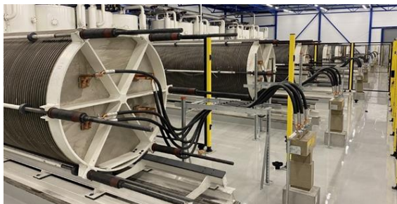
水素プラントの電解装置
