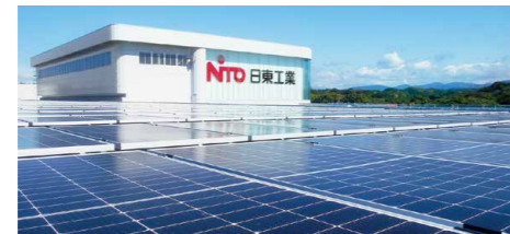
太陽光発電設備(菊川工場 物流倉庫屋根)
