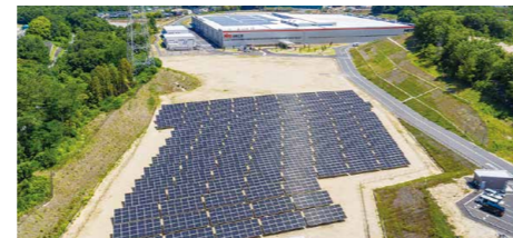
太陽光発電設備(瀬戸工場 1,134kW)
