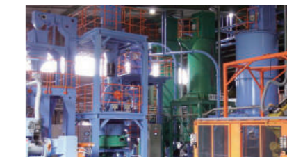
▲タイルカーベトリサイクルプラント1号機
