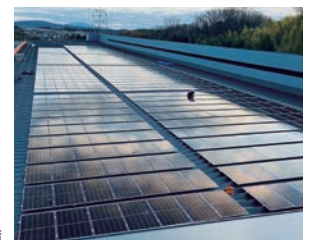
生駒事業所の太陽光発電設備
