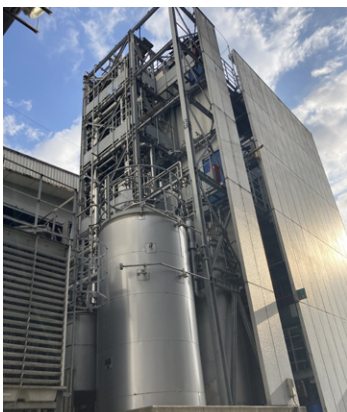
溶剤のクローズドリサイクルが行われている施設(蒸留塔)
