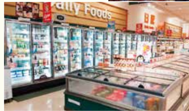
エネルギー効率が高い冷蔵・冷凍ショーケース
