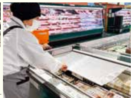
閉店時に冷気漏れ防止カバーを下ろす
