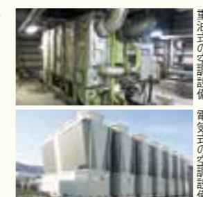
重油式の空調設備 電気式の空調設備
