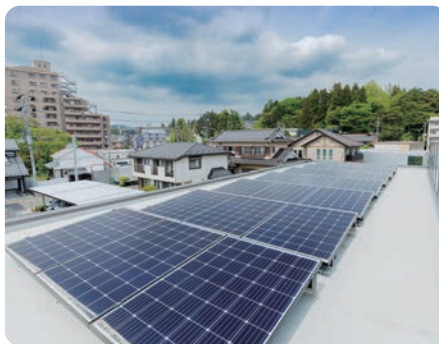
太陽光パネル
