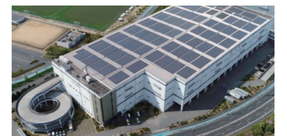
堺ロジスティクスセンター 太陽光パネル
