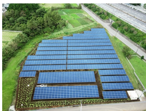
リエネ静岡電太陽光発電所
