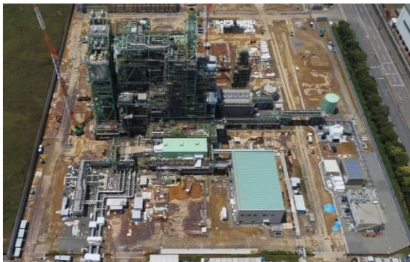
発電所全景（南側から北側を望む）
