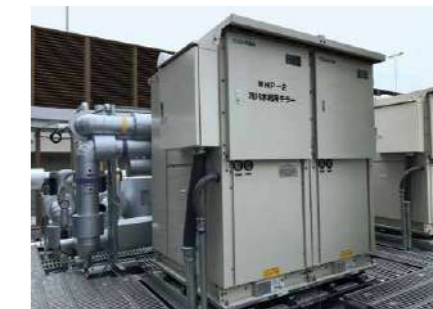
河川水利用ヒートポンプ
