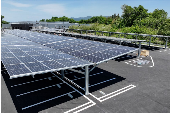
カーポートに設置された太陽光発電設備
