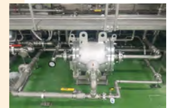
スパイラル式排熱回収装置 茹麺装置の排熱を回収し、重油の使用量を削減する装置。CO 2 排出削減に貢献
