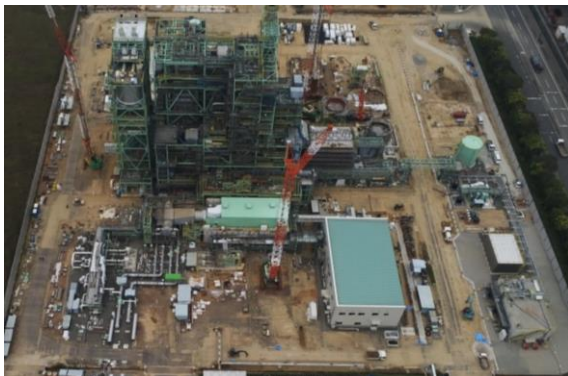
発電所全景（南側から北側を望む）
