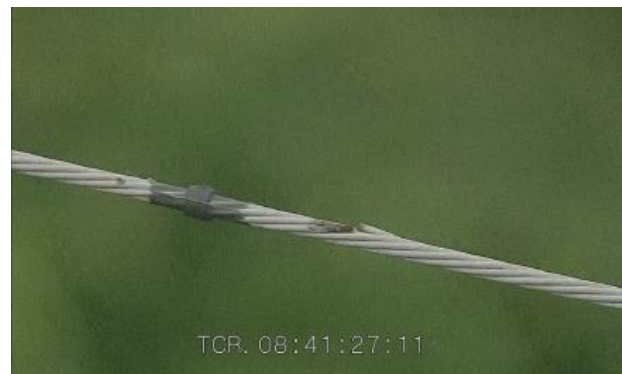
「架空地線」の素線切れの様子
