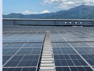
太陽光パネル 海老名工場
