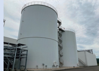
メタン発酵設備 大樹工場
