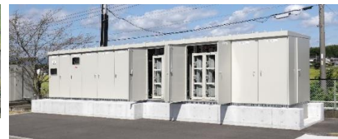
産業用太陽光自家消費蓄電池システム「サファLink-ONE」実証機 (掛川工場)
