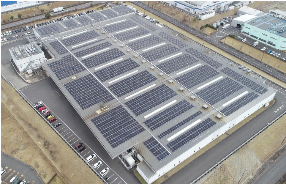
（安永 ゆめぼりす工場 太陽光発電システム）
