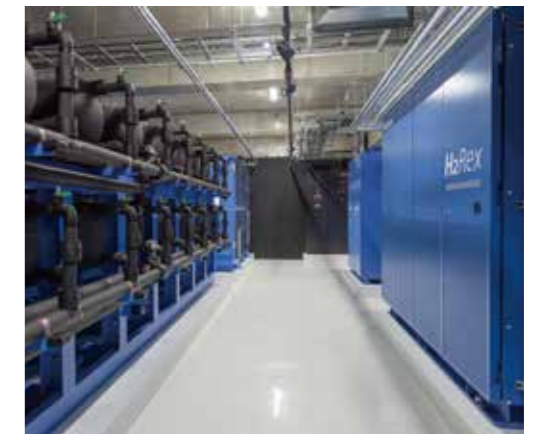
当社北陸支店で稼働中の「Hydro Q-BiC」
