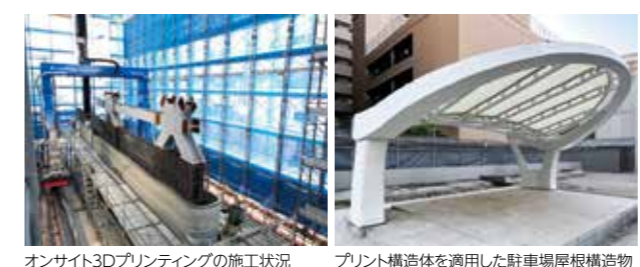
オンサイト3Dプリンティングの施工状況 プリント構造体を適用した駐車場屋根構造体
