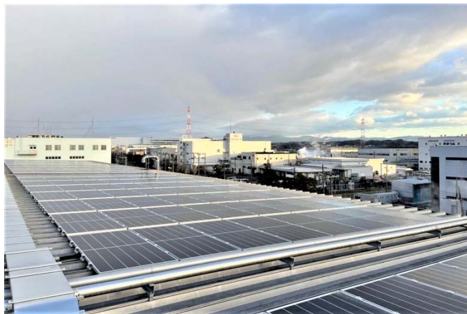
（株式会社やまみ 関西工場 滋賀県甲賀市 発電容量：386.4kW）
