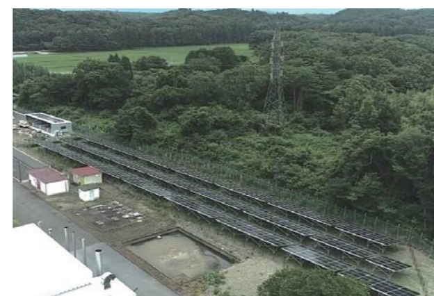
那須工場の太陽光発電設備
