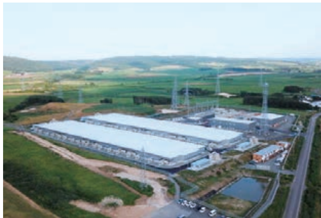
国内最大規模のリチウムイオン蓄電池システム
